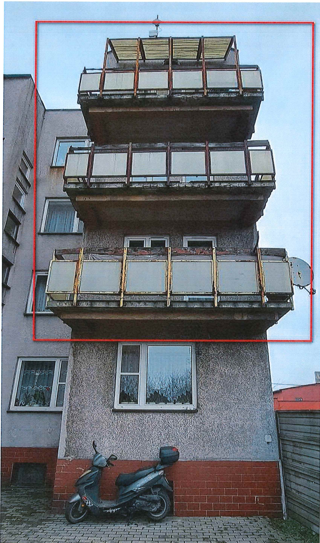
Fot. 6. Elewacja tylna– widok balkonów do remontu.
