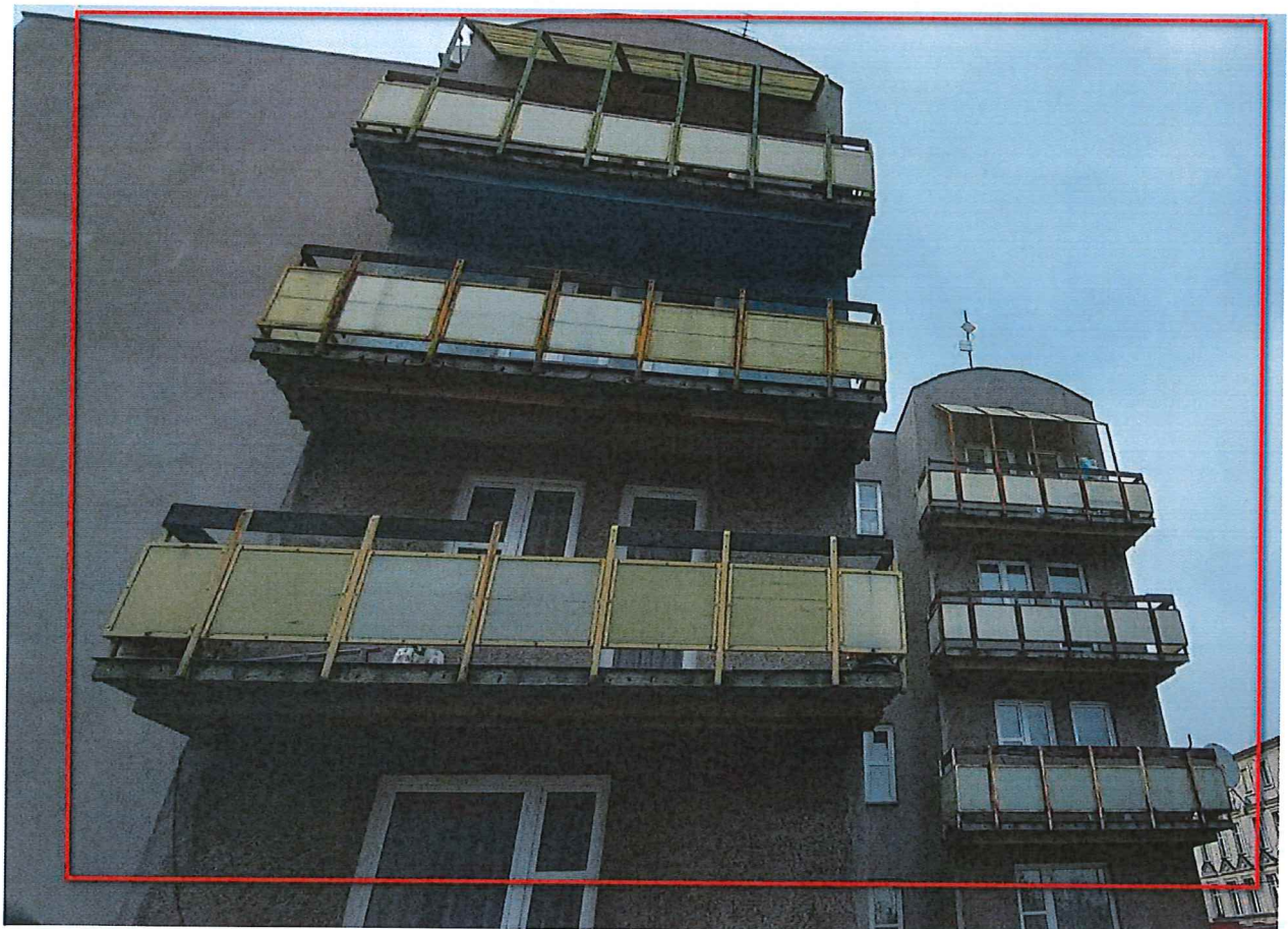
Fot. 4. Elewacja tylna – widok balkonów do remontu.
