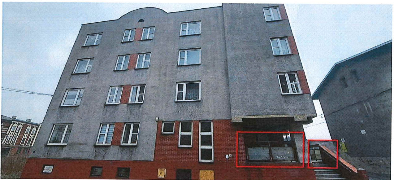
Fot. 2. Strefa wejściowa do budynku (elewacja frontowa) – balustrady do oczyszczenia i pomalowania.
