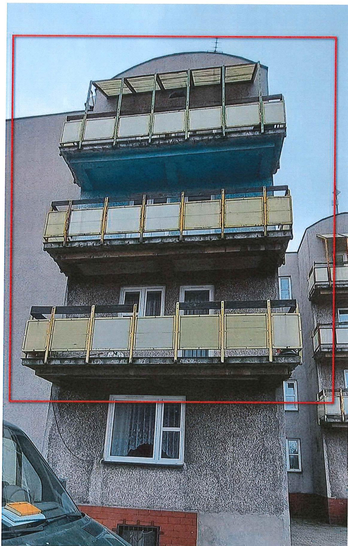
Fot. 5. Elewacja tylna– widok balkonów do remontu.
