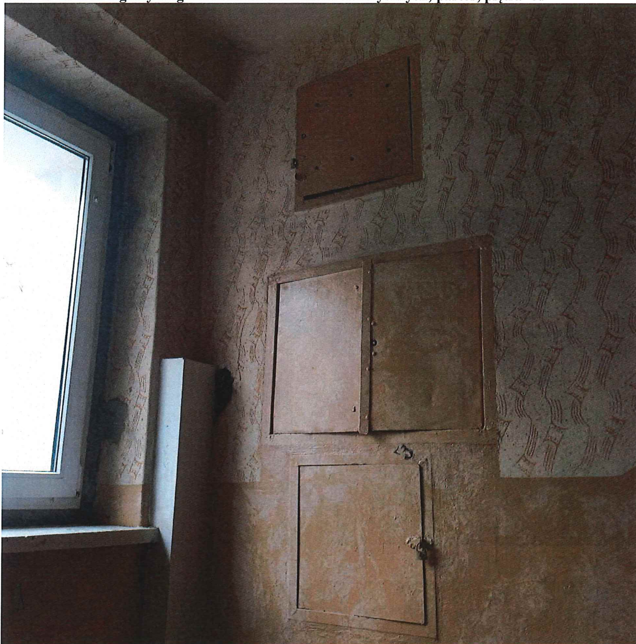
Foto 2a- Widok Ogólny fragmentu klatki oraz tablic elektrycznych; parter, piętra- cd
