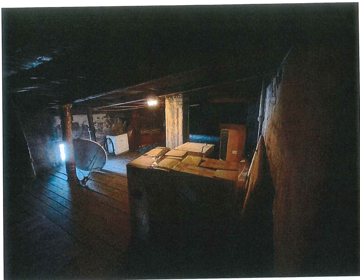
Fot. 10. Widok poddasza nieużytkowanego – więźba dachowa do wzmocnienia lub wykonania na nowo.
