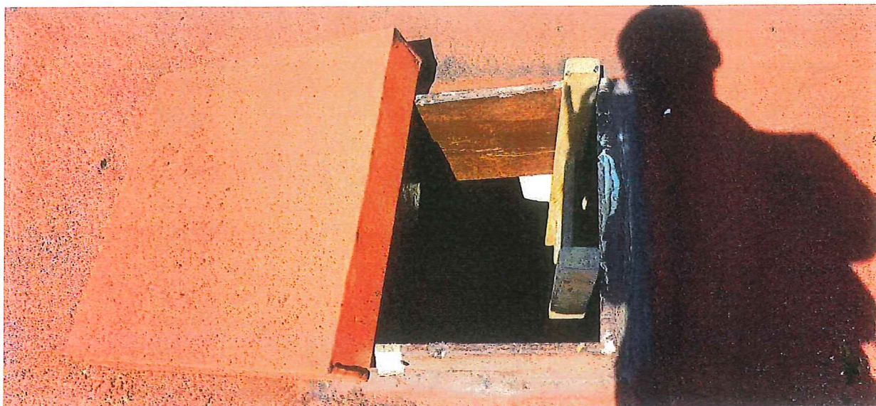
Fot. 5. Widok wyłazu dachowego – do wymiany na nowy, systemowy.
