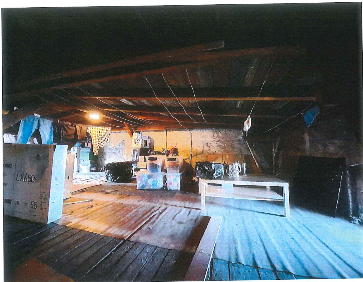
Fot. 16. Widok poddasza nieużytkowanego – więźba dachowa do wzmocnienia lub wykonania na nowo.
