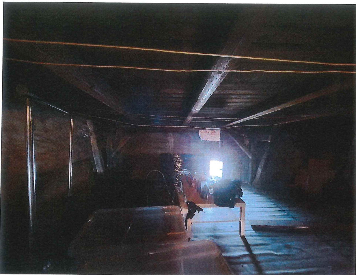
Fot. 18. Widok poddasza nieużytkowanego – więźba dachowa do wzmocnienia lub wykonania na nowo.
