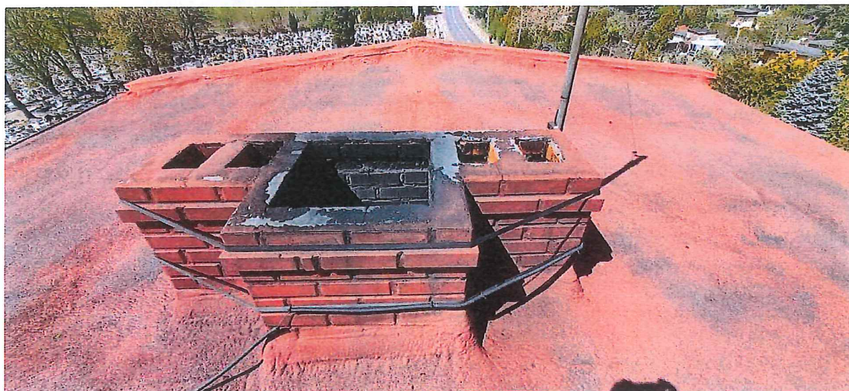
Fot. 6. Widok komina dymowo – wentylacyjnego – do przemurowania.
