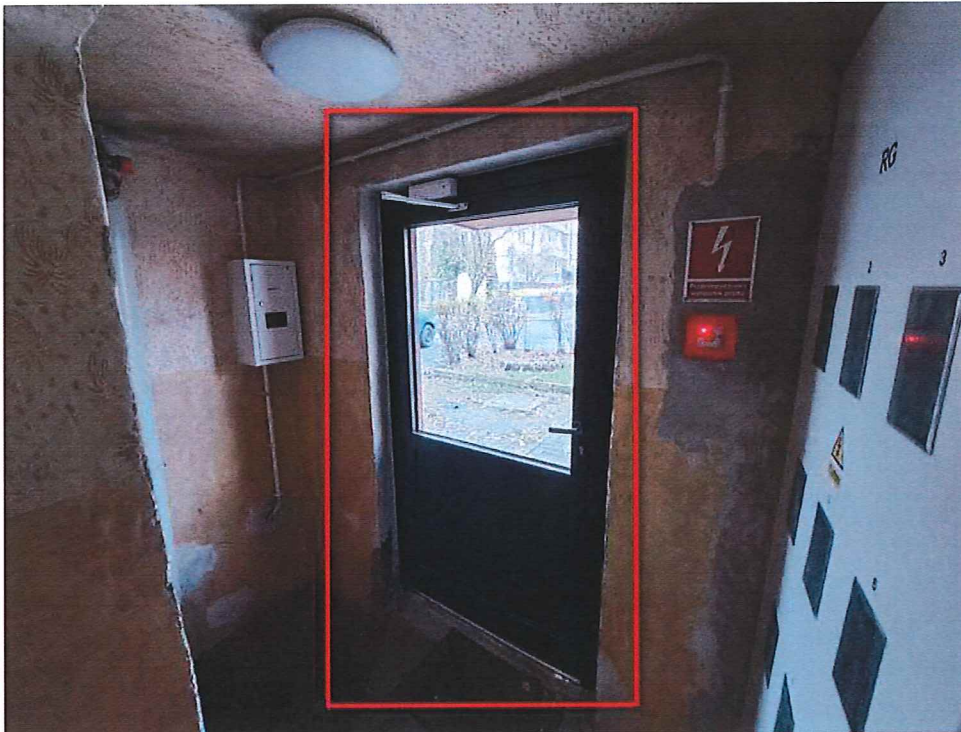
Fot. 24. Widok ogólny klatki nr II – drzwi wejściowe do klatki do wymiany na nowe.
