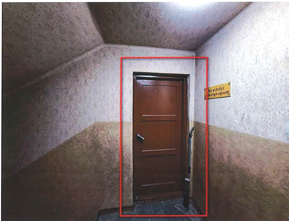
Fot. 21. Widok ogólny klatki nr I – drzwi na strych do wymiany na nowe o odporności EI30.
