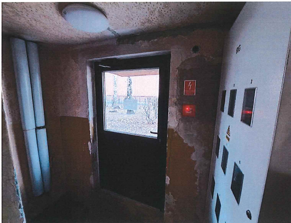
Fot. 22. Widok ogólny klatki nr I – parter – otuliny do poprawy, próg do uzupełnienia.
