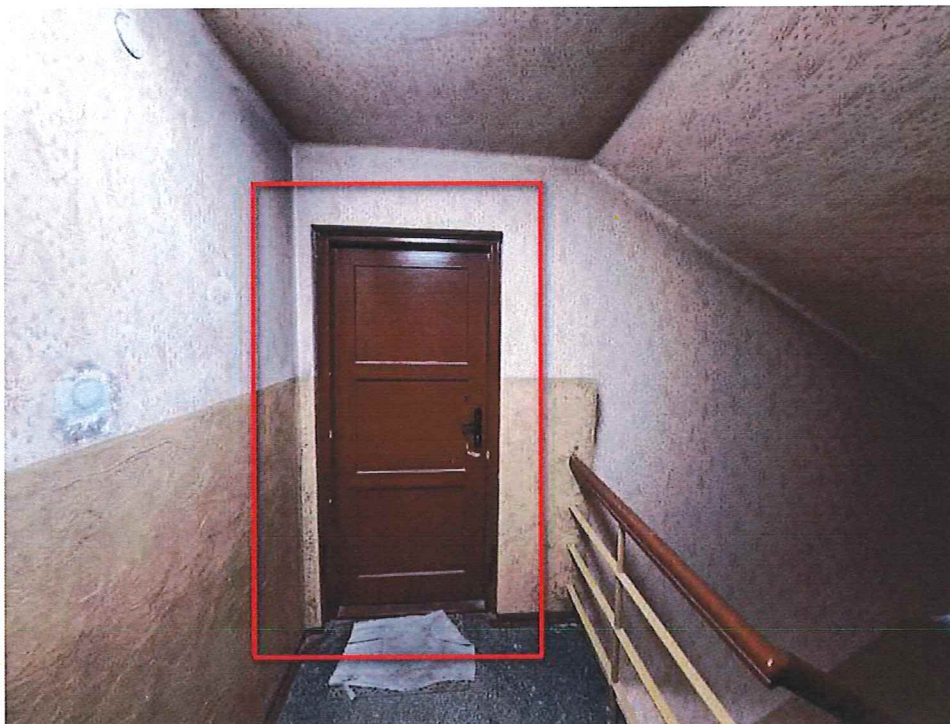
Fot. 20. Widok ogólny klatki nr I – drzwi na strych do wymiany na nowe o odporności EI30.
