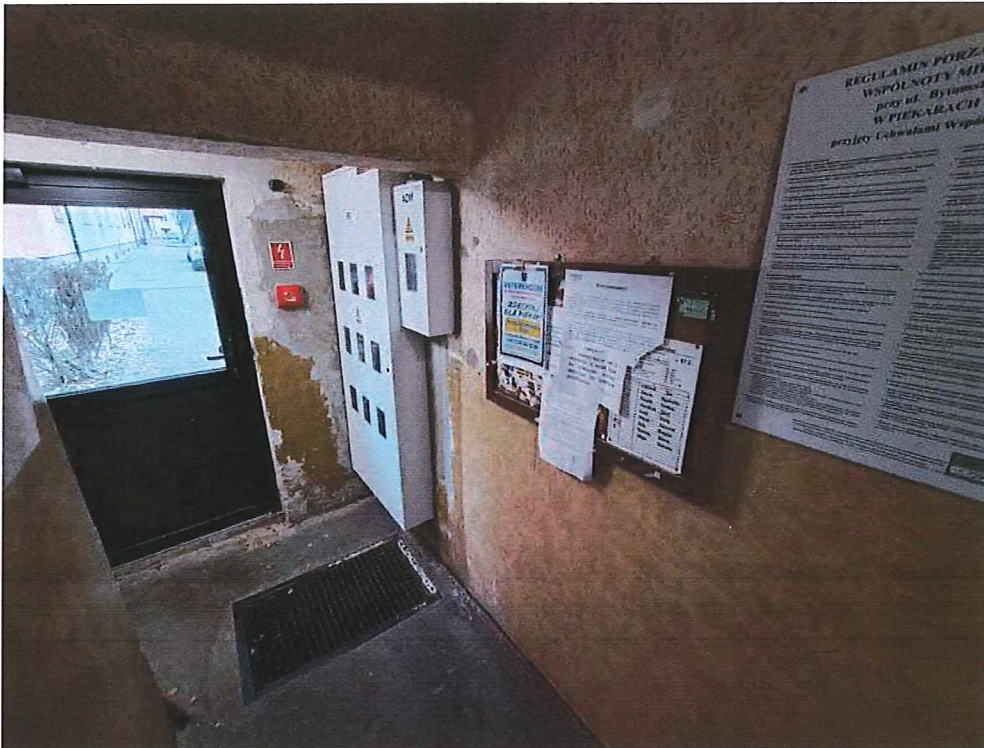
Fot. 7. Widok ogólny klatki nr I – parter – dostawa i montaż nowej wycieraczki, na posadzce nowe płytki.
