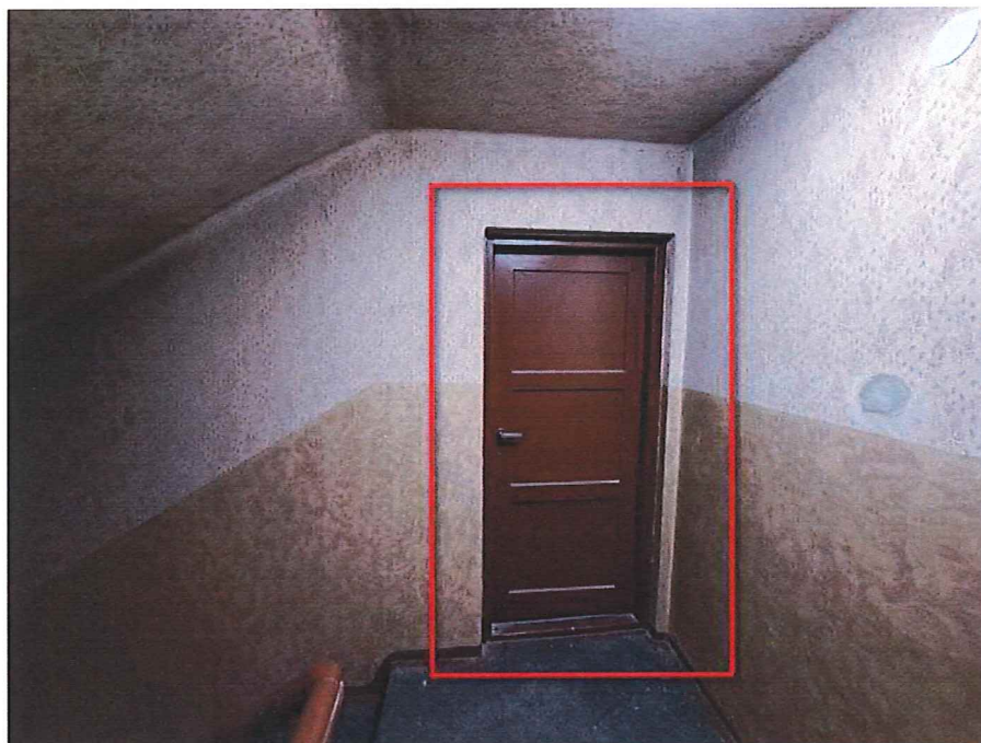
Fot. 35. Widok ogólny klatki nr II – drzwi na strych do wymiany na nowe o wytrzymałości EI30.
