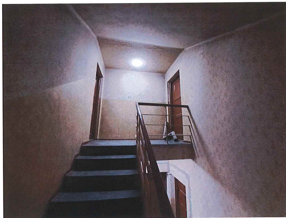
Fot. 33. Widok ogólny klatki nr II – drzwi na strych do wymiany na nowe o wytrzymałości EI30.
