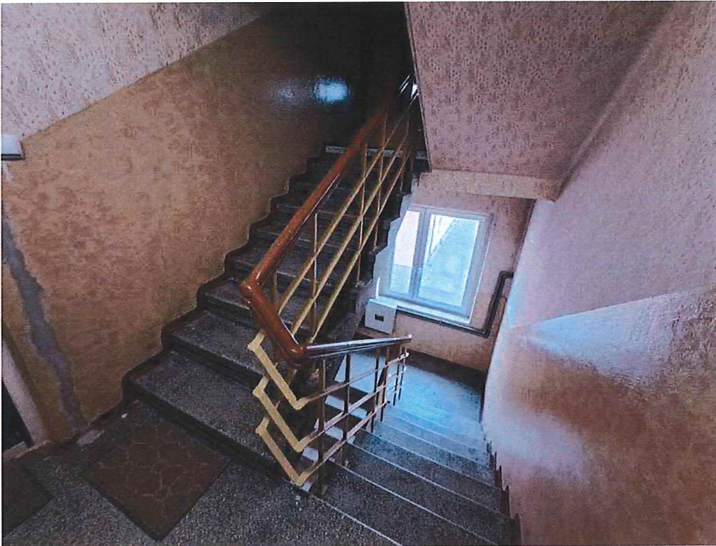
Fot. 16. Widok ogólny klatki nr I – infrastruktura teletechniczna do uporządkowania, otuliny do uzupełnienia.
