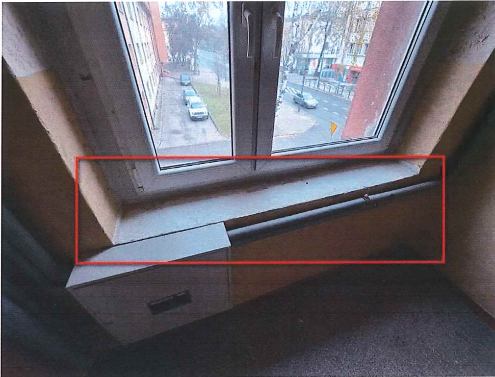
Fot. 15. Widok ogólny klatki nr I – otuliny do uzupełnienia, nowy parapet do osadzenia.
