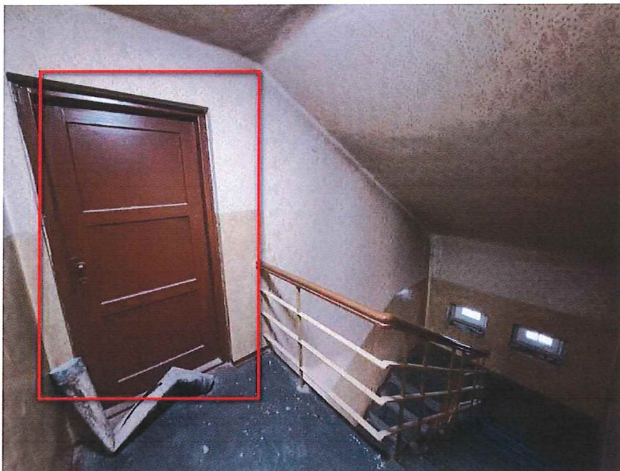
Fot. 34. Widok ogólny klatki nr II – drzwi na strych do wymiany na nowe o wytrzymałości EI30.
