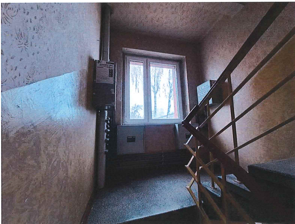
Fot. 10. Widok ogólny klatki nr I – infrastruktura teletechniczna do uporządkowania, otuliny do uzupełnienia.
