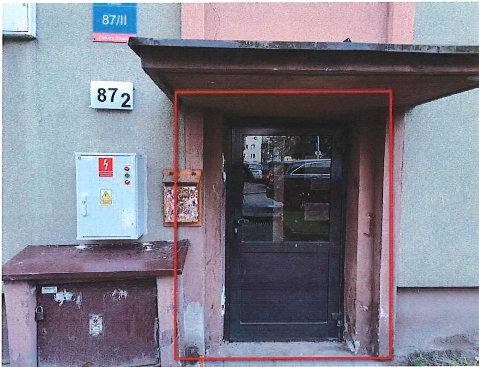
Fot. 23. Widok ogólny klatki nr II – drzwi wejściowe do klatki do wymiany na nowe.
