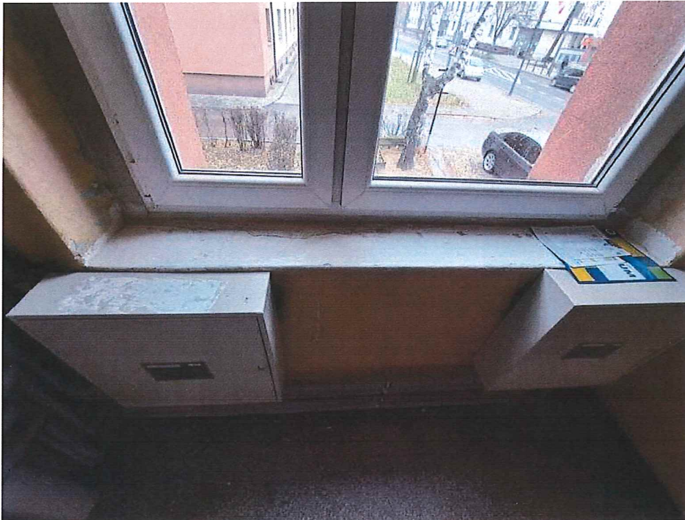
Fot. 11. Widok ogólny klatki nr I – otuliny do uzupełnienia, nowy parapet do osadzenia.
