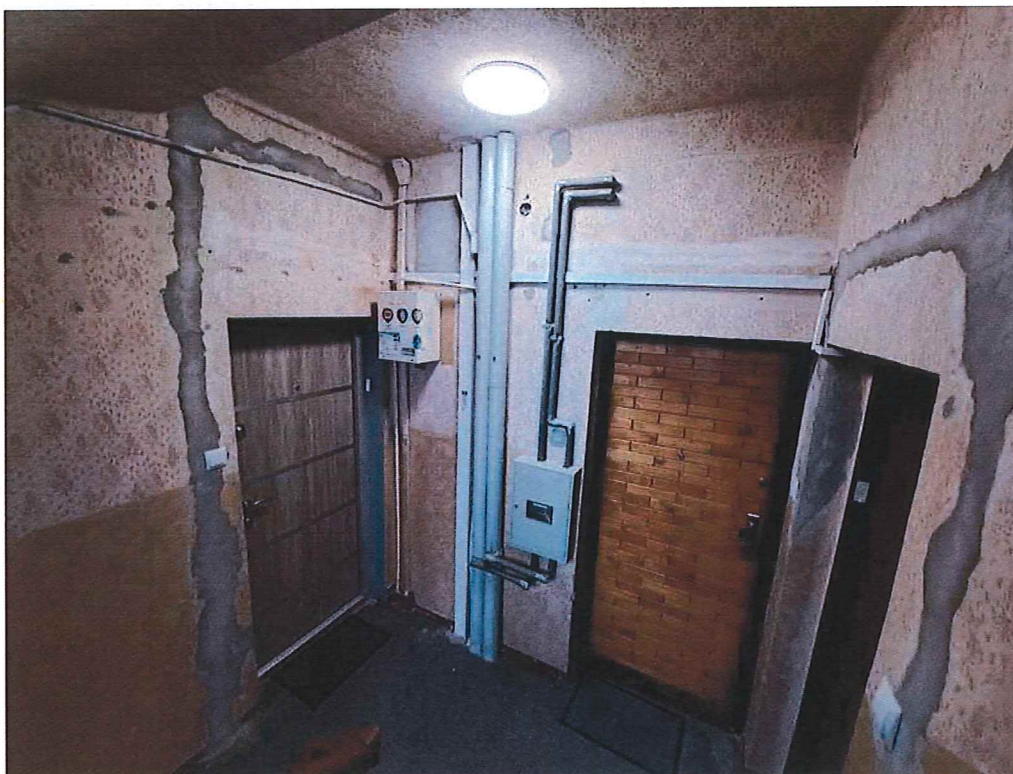
Fot. 31. Widok ogólny klatki nr II – infrastruktura teletechniczna do uporządkowania, otuliny do uzupełnienia.
