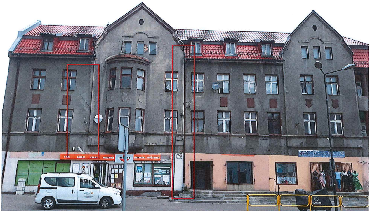
Fot. 3. Widok elewacji frontowej wraz z zaznaczonymi pęknięciami.
