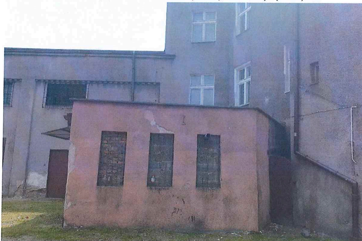
Fot. 14. Elewacja północno-wschodnia. Zabrudzenia ścian.. Zamurowane okna przedsionka.
