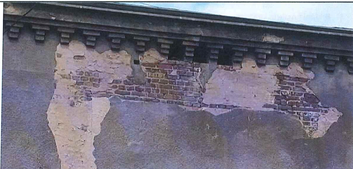
Fot. 4. Ubytki tynku na elewacji
