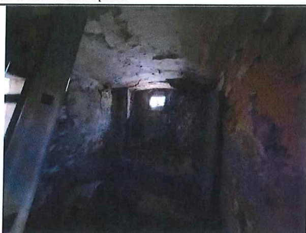
Fot. 25. Częściowo zamurowane okno
