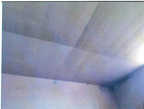
Fot. 44. Sufit hali. Widoczne odkształcenia płyt
