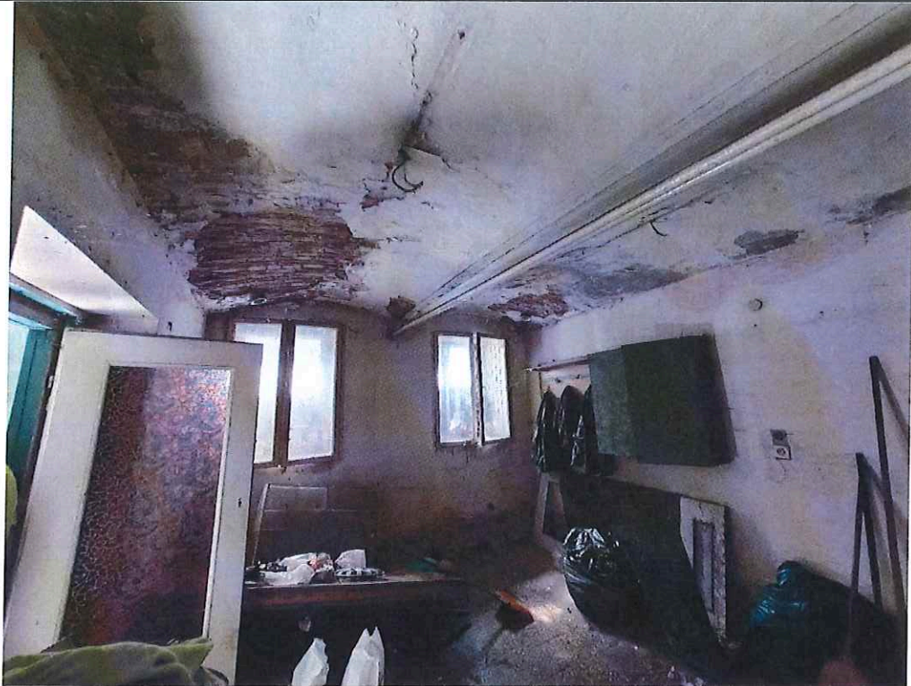
Fot.15, 16. Piwnica (wejście od strony ulicy). Widoczne ubytki tynku, zmurszenie i zawilgocenie cegieł.
