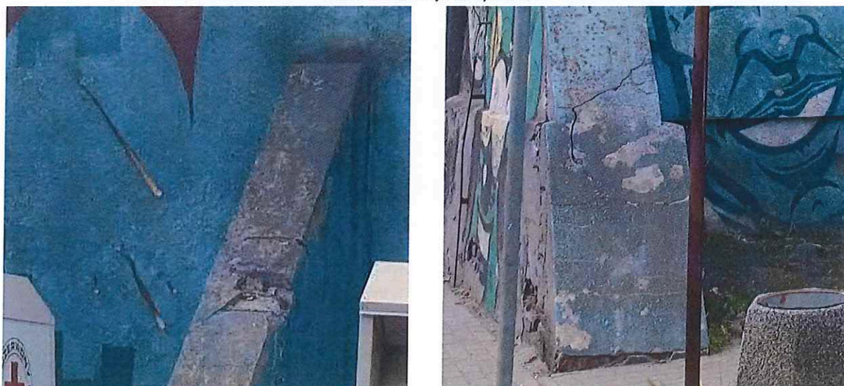
Fot.11, 12. Uszkodzenia przypór
