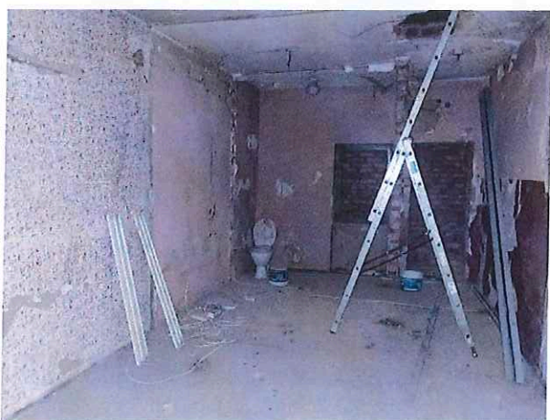
Fot. 50. Zamurowane otwór okienny i drzwiowy (od strony podwórka). Widoczny otwór w stropie nad antresolą.
