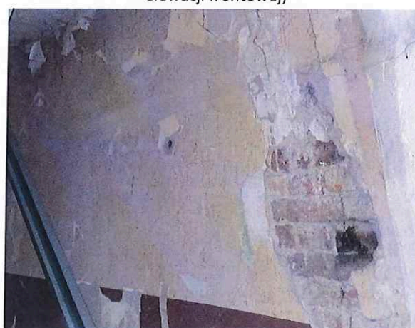
Fot. 51. Odspojenia tynku i uszkodzenia ściany kominowej.
