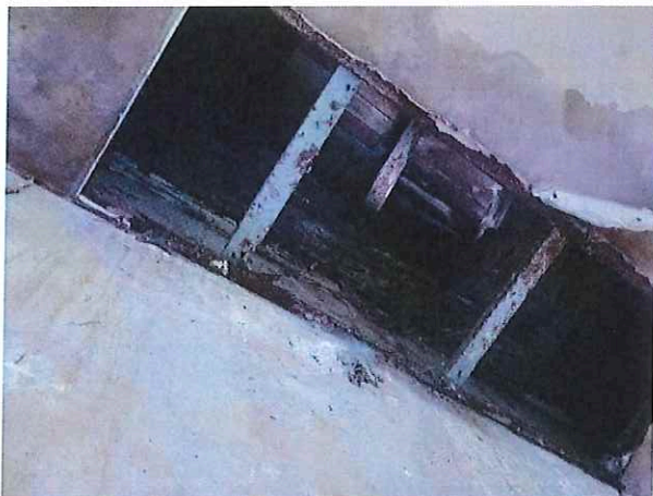
Fot. 65. Otwór w suficie. Widoczna stalowa konstrukcja sufitu, belka stropowa i więźba dachowa
