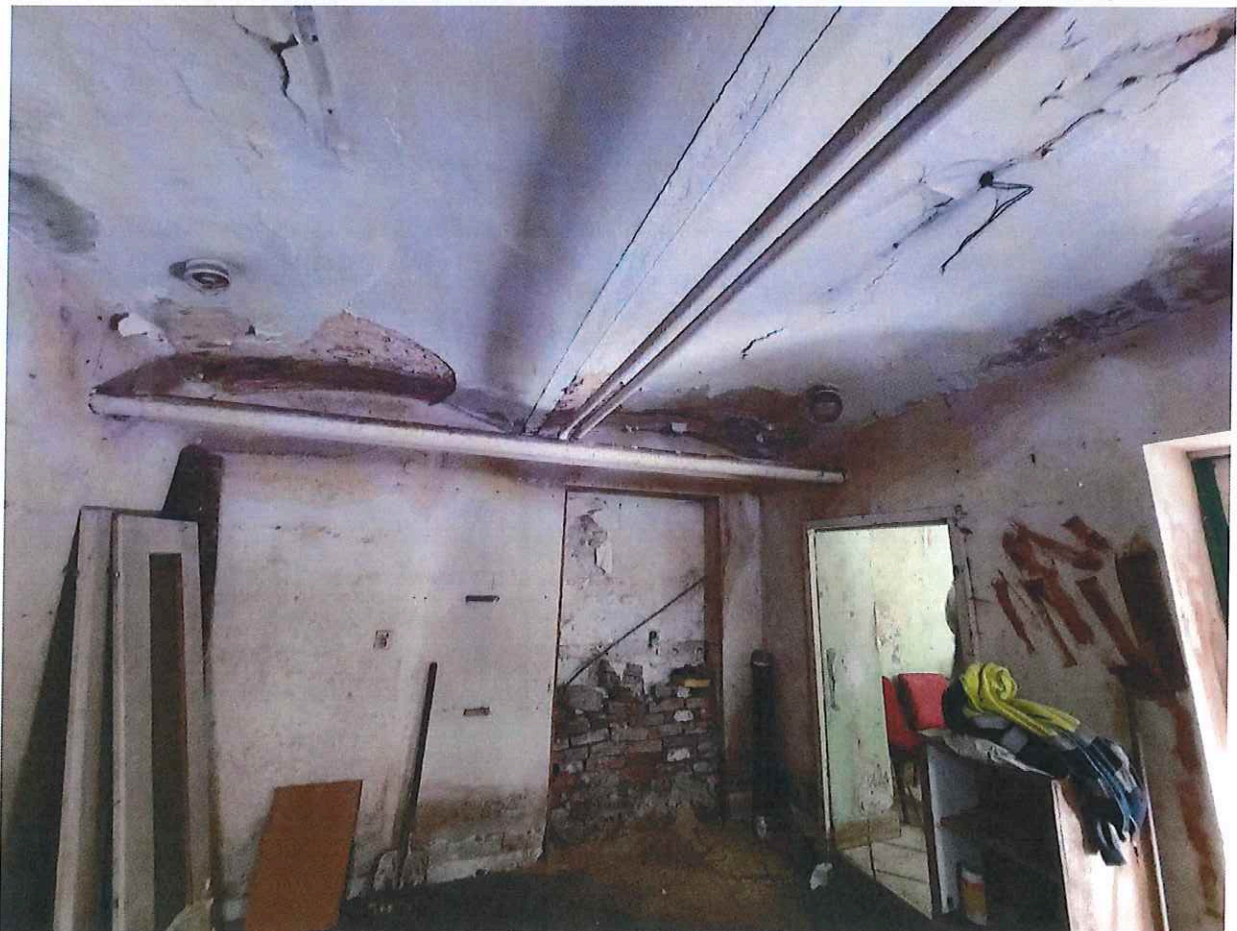
Fot.17. Widok na zamurowane przejście w piwnicy. Widoczne zawilgocenia, zmurszenia cegieł, ubytki tynku, korozja belek stalowych.
