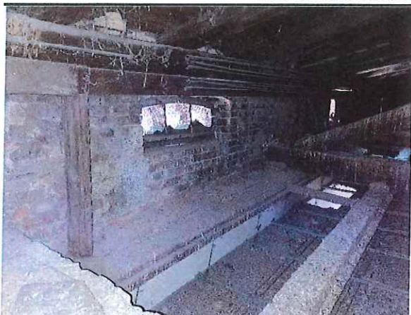
Fot. 56. Widok na okno strychowe i uszkodzony sufit nad halą
