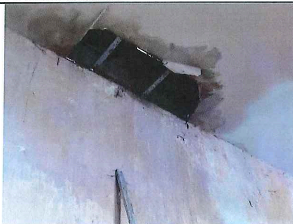
Fot. 45. Otwór w suficie. Widoczne ślady po zalaniu
