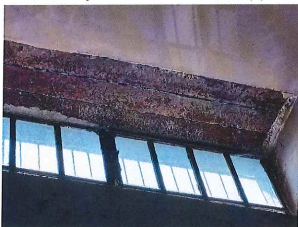
Fot. 46. Skorodowane stalowe nadproże okienne
