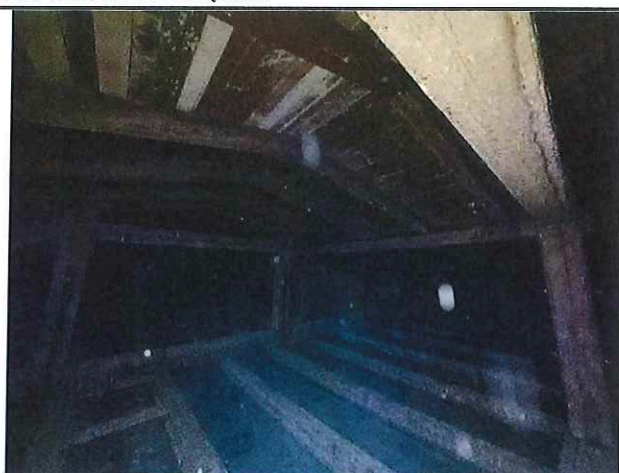
57. Deskowanie dachu – część elementów znacznie zagrzybiona i zbutwiała, część wymieniona
