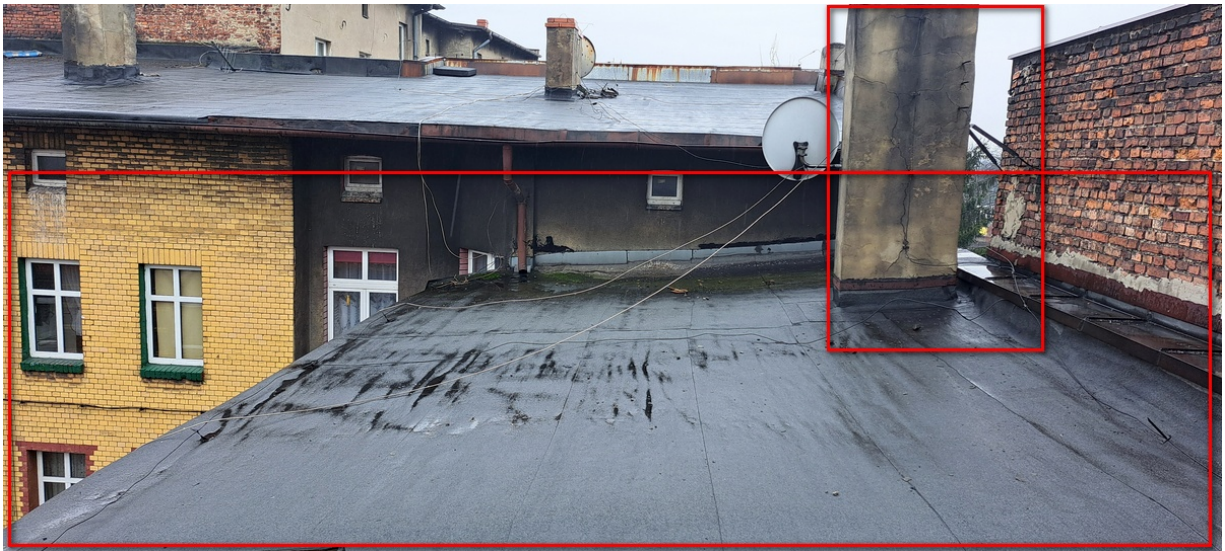
Fot. 5. Widok komina do przemurowania.
