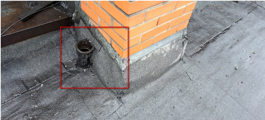
Fot. 8. Widok wywiewki kanalizacyjnej do wymiany na nową.
