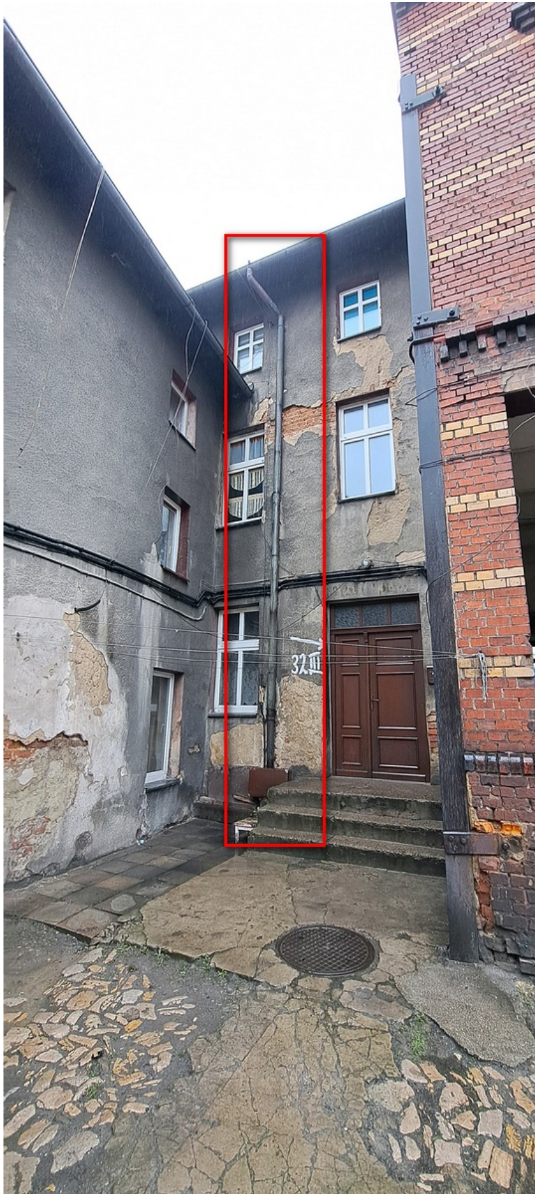
Fot. 11. Widok orynnowania części wyższej do wymiany.
