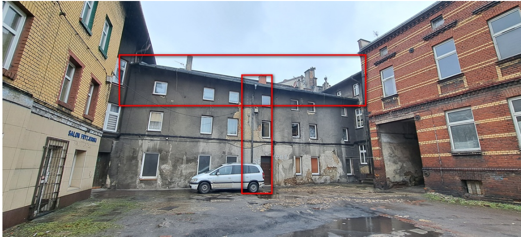
Fot. 2. Widok ogólny budynku z zaznaczoną połącią i orynnowaniem do wymiany.
