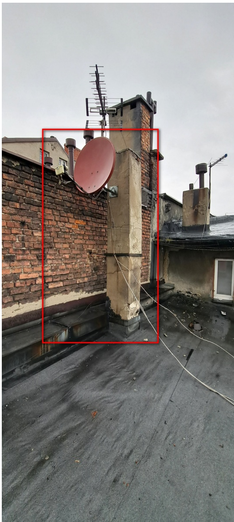
Fot. 13. Widok komina do przemurowania.
