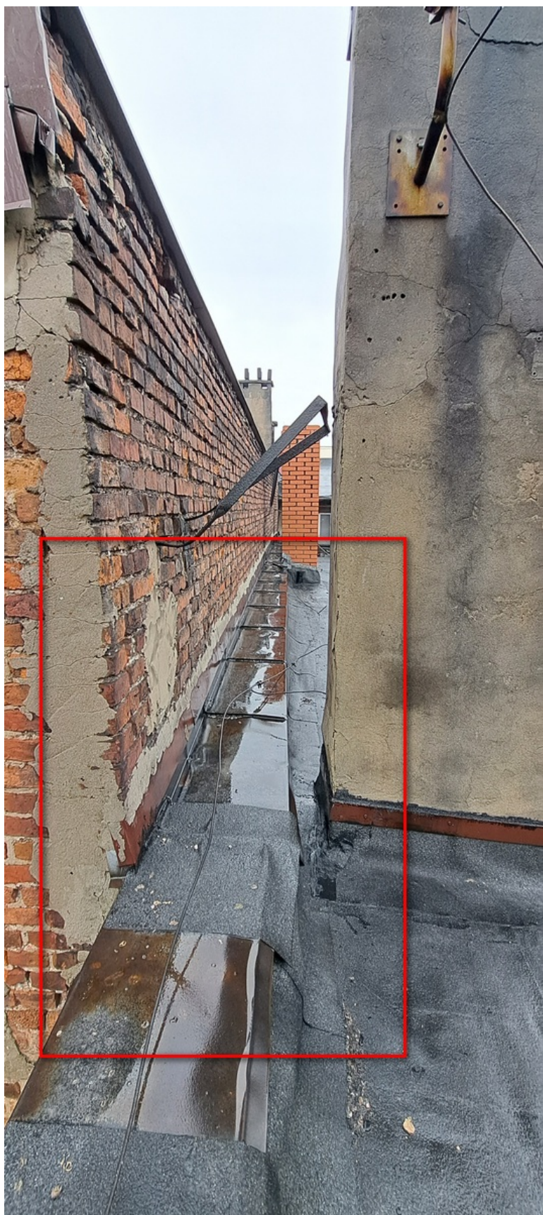
Fot. 7. Widok obróbki blacharskiej do wykonania na nowo.
