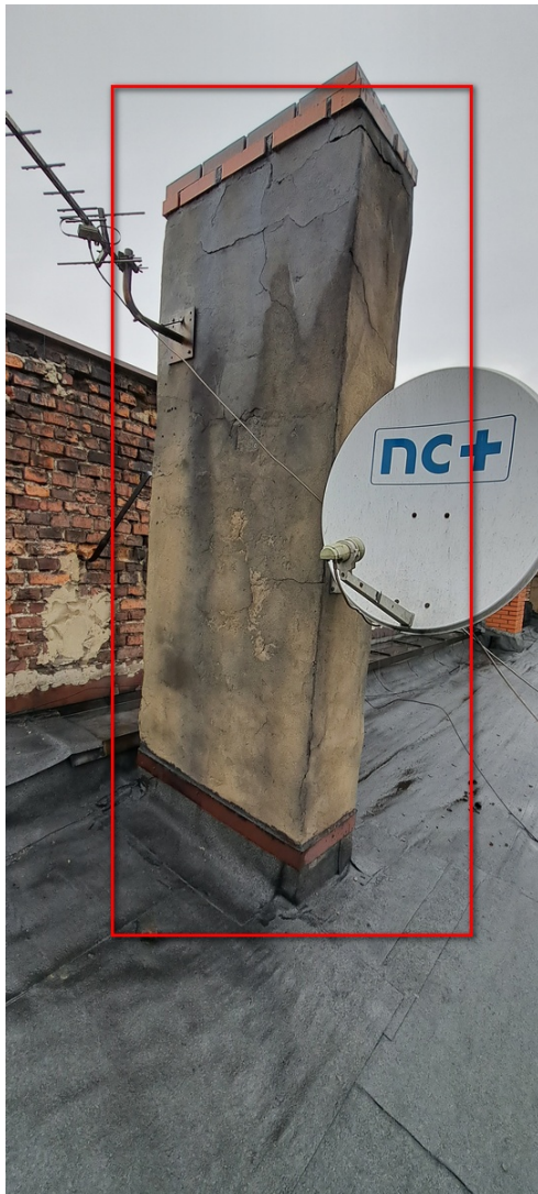
Fot. 6. Widok komina do przemurowania.
