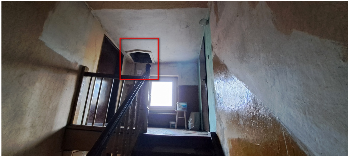
Fot. 14. Strefa wyjściowa na dach z klatki schodowej – wyłaz do wymiany na nowy.
