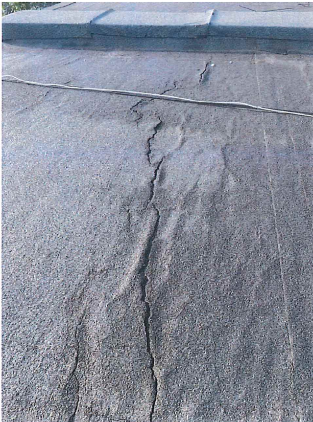
Fot. 2. Widok uszkodzonego pokrycia z papy.
