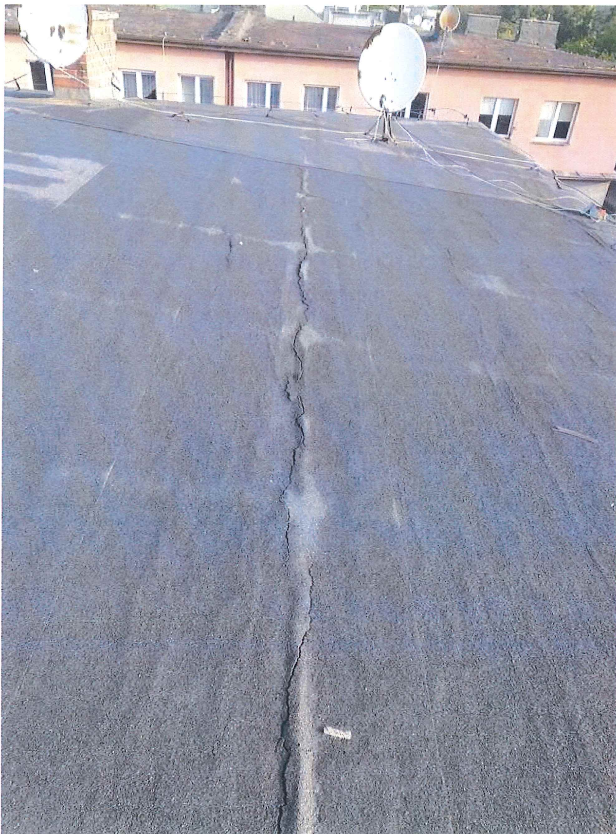
Fot. 4. Widok uszkodzonego pokrycia z papy.
