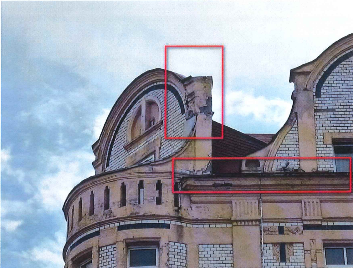
Fot. 6. Zbliżenie na fragment attyki i gzymsu do przemurowania (od strony ul. Bytomskiej).
