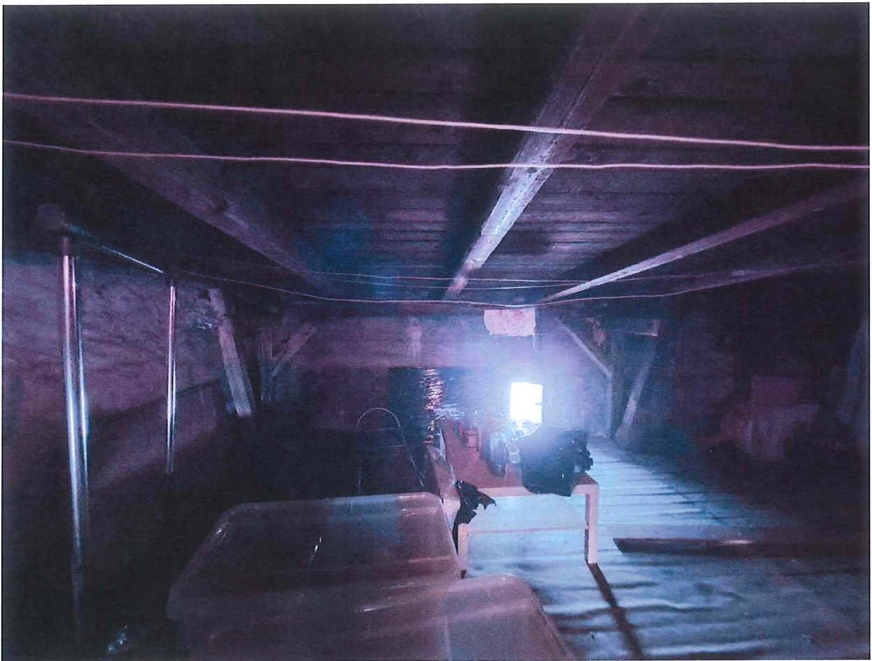
Fot. 18. Widok poddasza nieużytkowanego – więźba dachowa do wzmocnienia lub wykonania na nowo.
