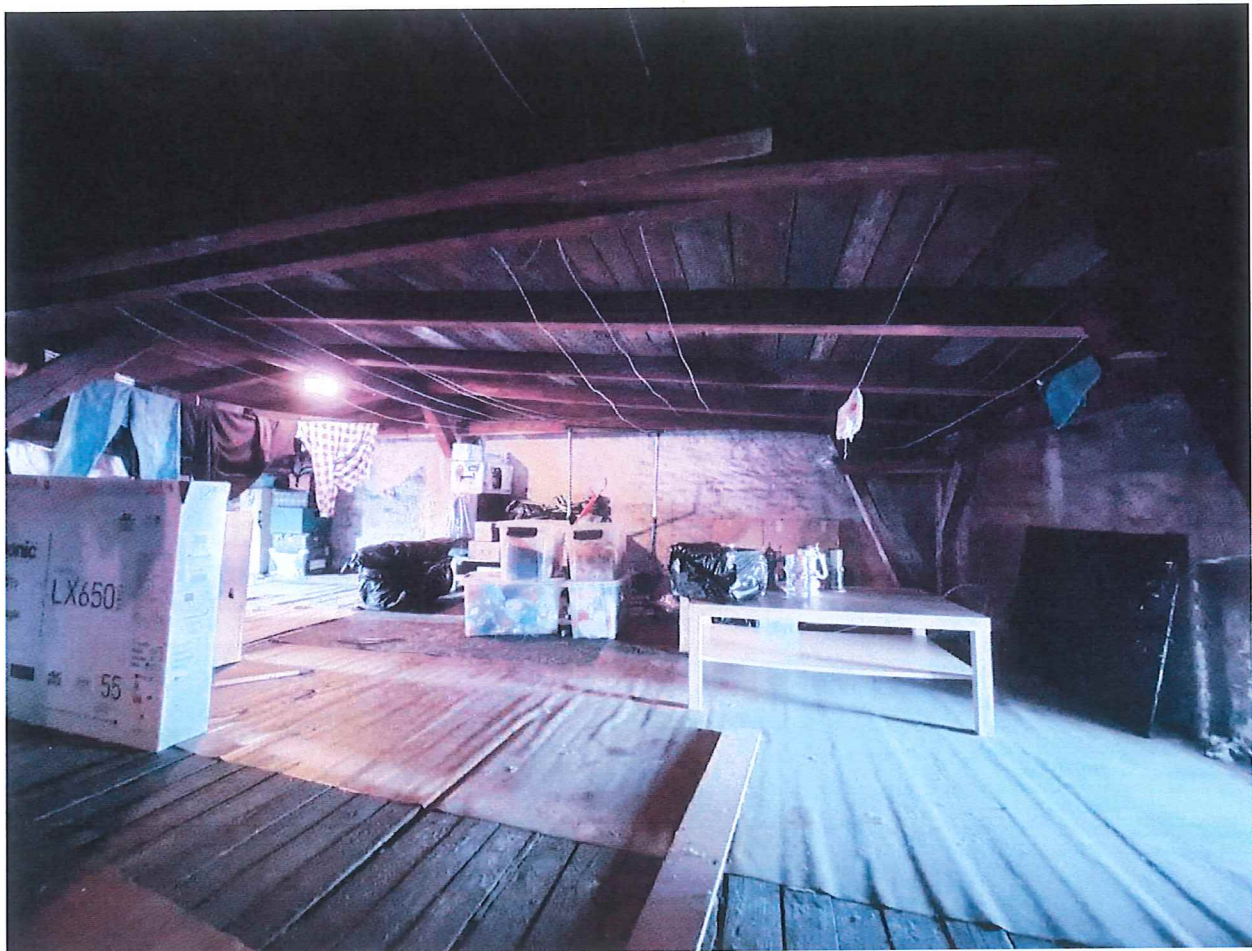
Fot. 16. Widok poddasza nieużytkowanego – więźba dachowa do wzmocnienia lub wykonania na nowo.
