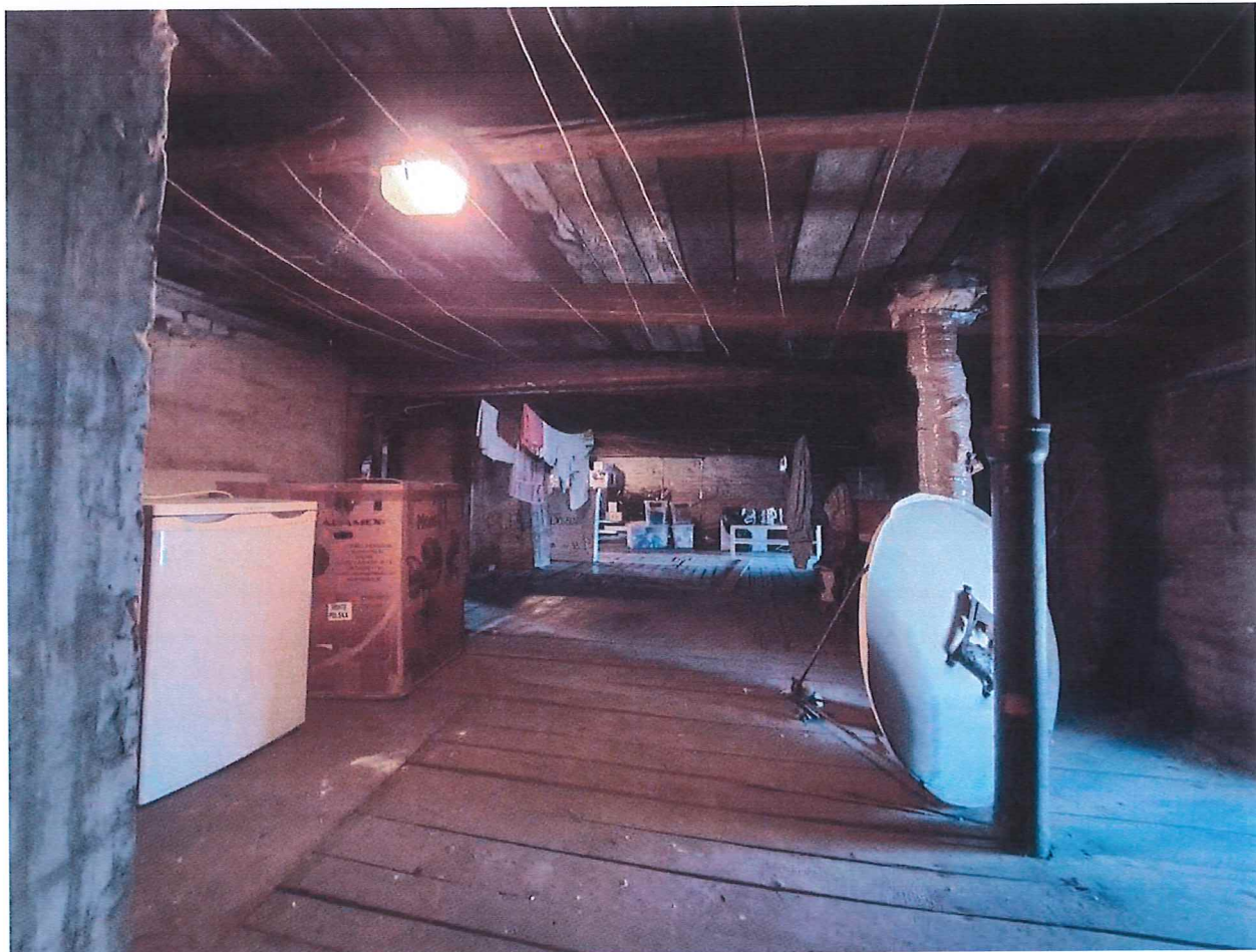
Fot. 11. Widok poddasza nieużytkowanego – więźba dachowa do wzmocnienia lub wykonania na nowo.
