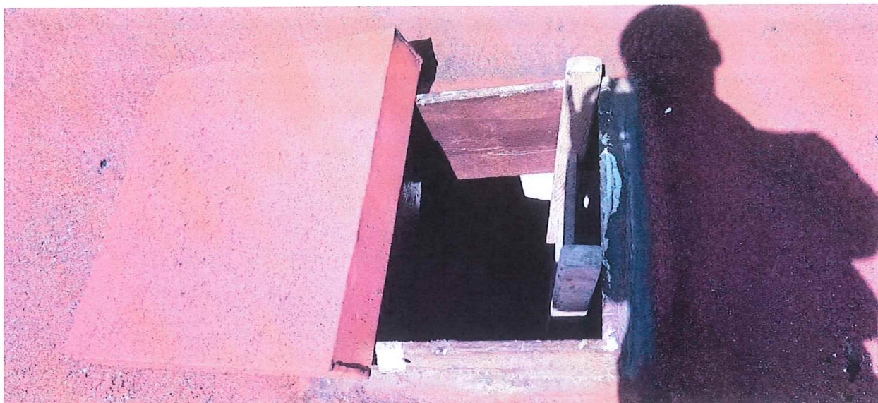
Fot. 5. Widok wylazu dachowego – do wymiany na nowy, systemowy.
