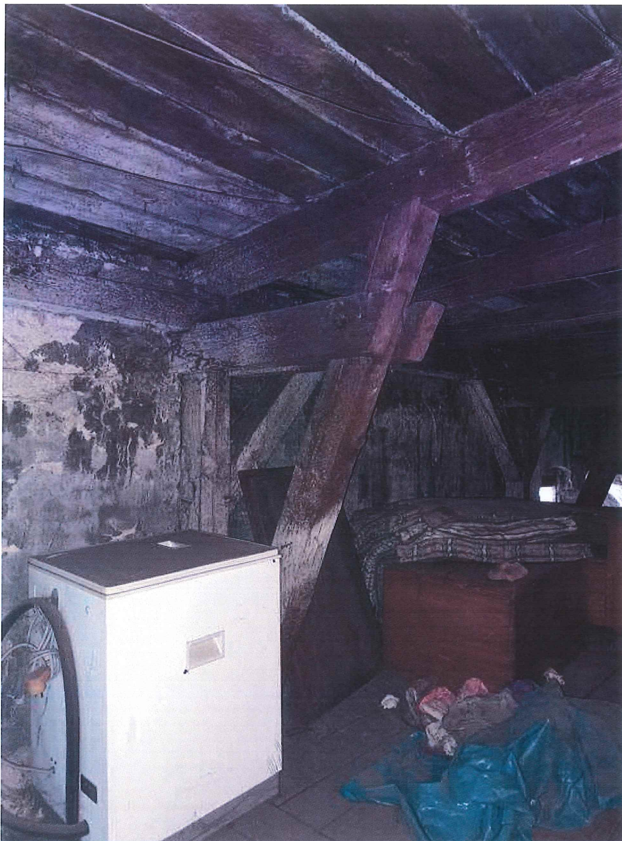
Fot. 12. Widok poddasza nieużytkowanego – więźba dachowa do wzmocnienia lub wykonania na nowo.
