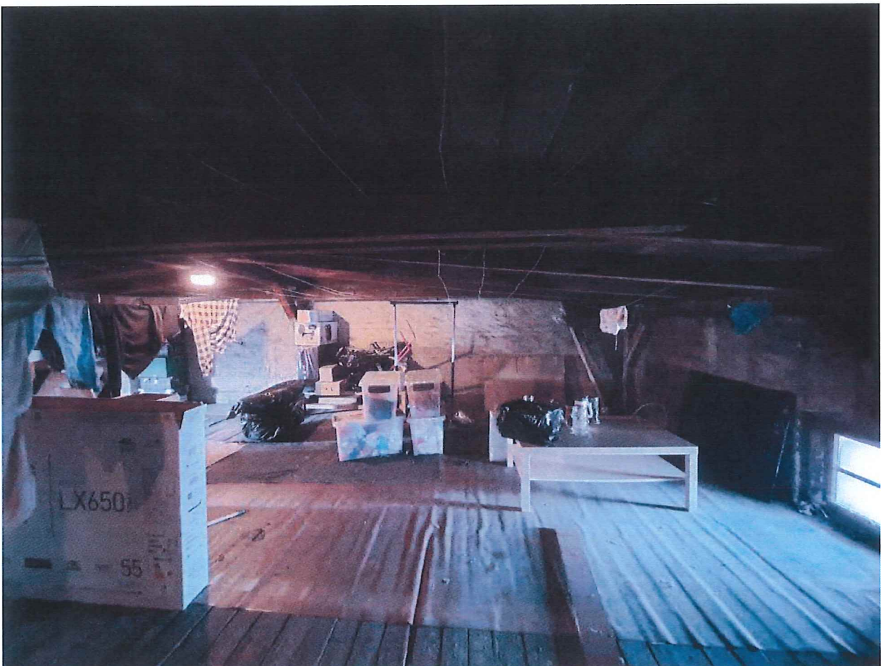
Fot. 19. Widok poddasza nieużytkowanego – więźba dachowa do wzmocnienia lub wykonania na nowo.
