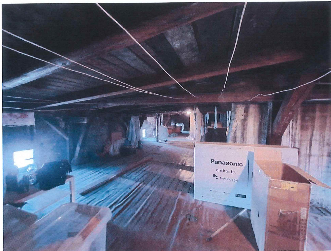
Fot. 17. Widok poddasza nieużytkowanego – więźba dachowa do wzmocnienia lub wykonania na nowo.
