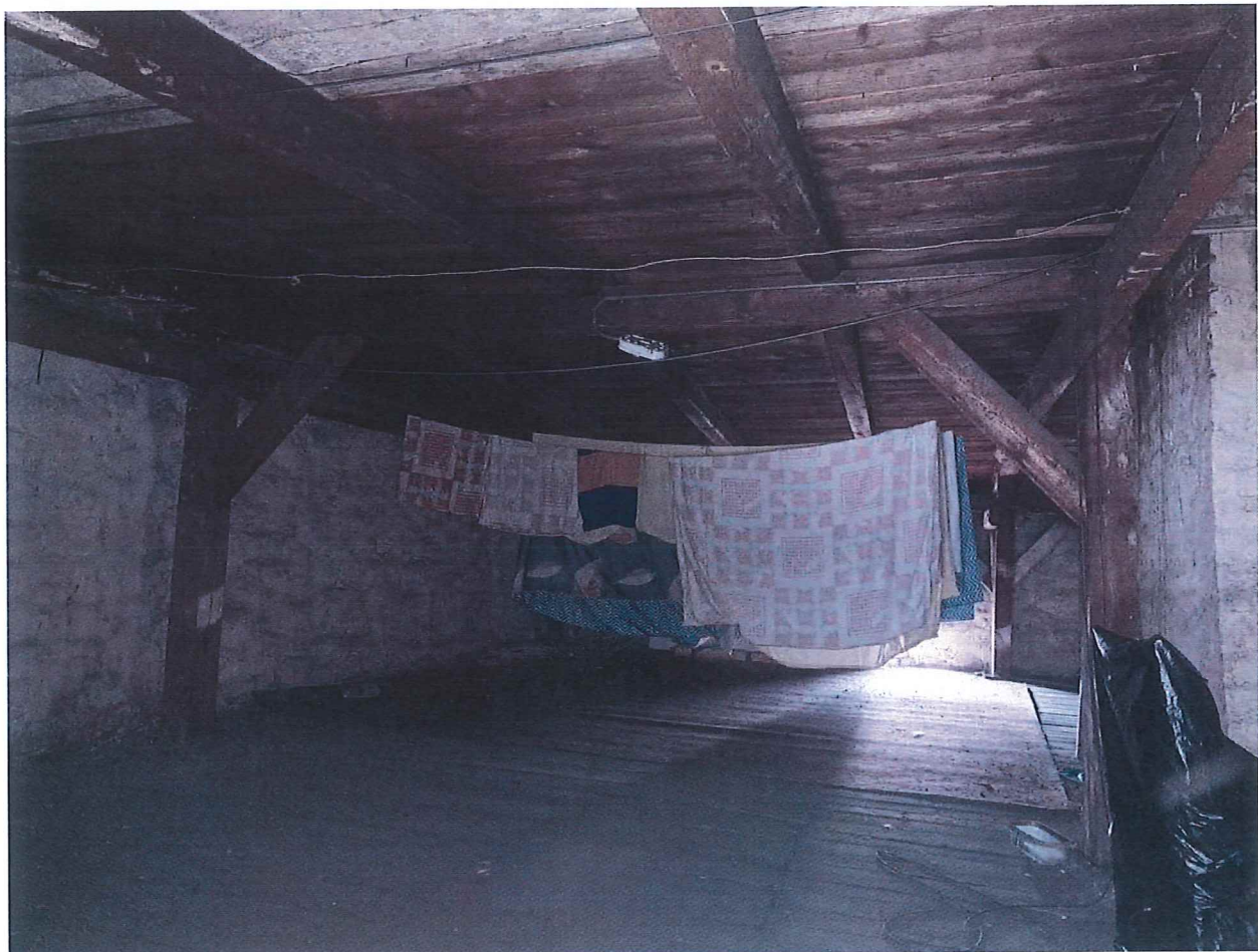
Fot. 14. Widok poddasza nieużytkowanego – więźba dachowa do wzmocnienia lub wykonania na nowo.
