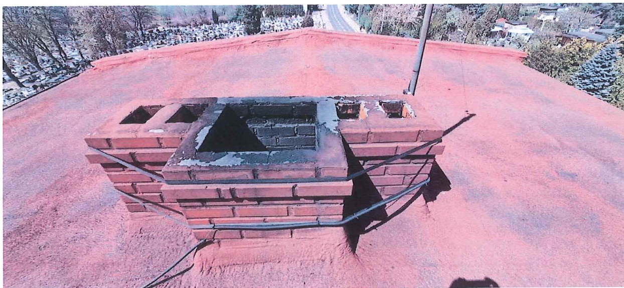
Fot. 6. Widok komina dymowo – wentylacyjnego – do przemurwania.
