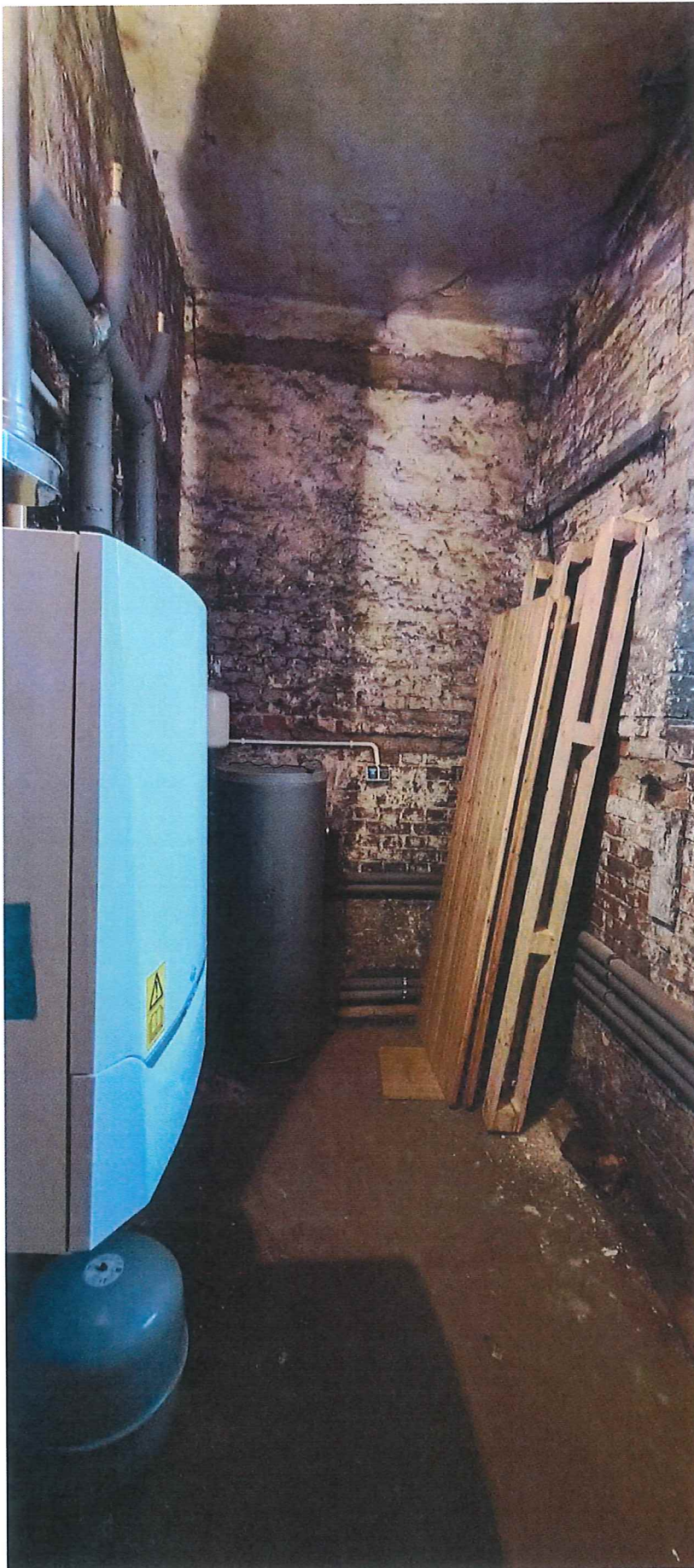
Fot. 4. Widok kotłowni.
