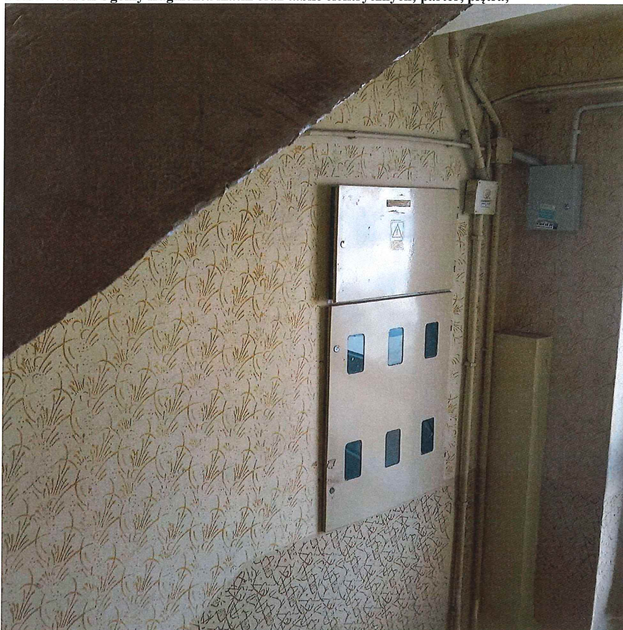
Foto 2- Widok Ogólny fragmentu klatki oraz tablic elektrycznych; parter, piętra;
