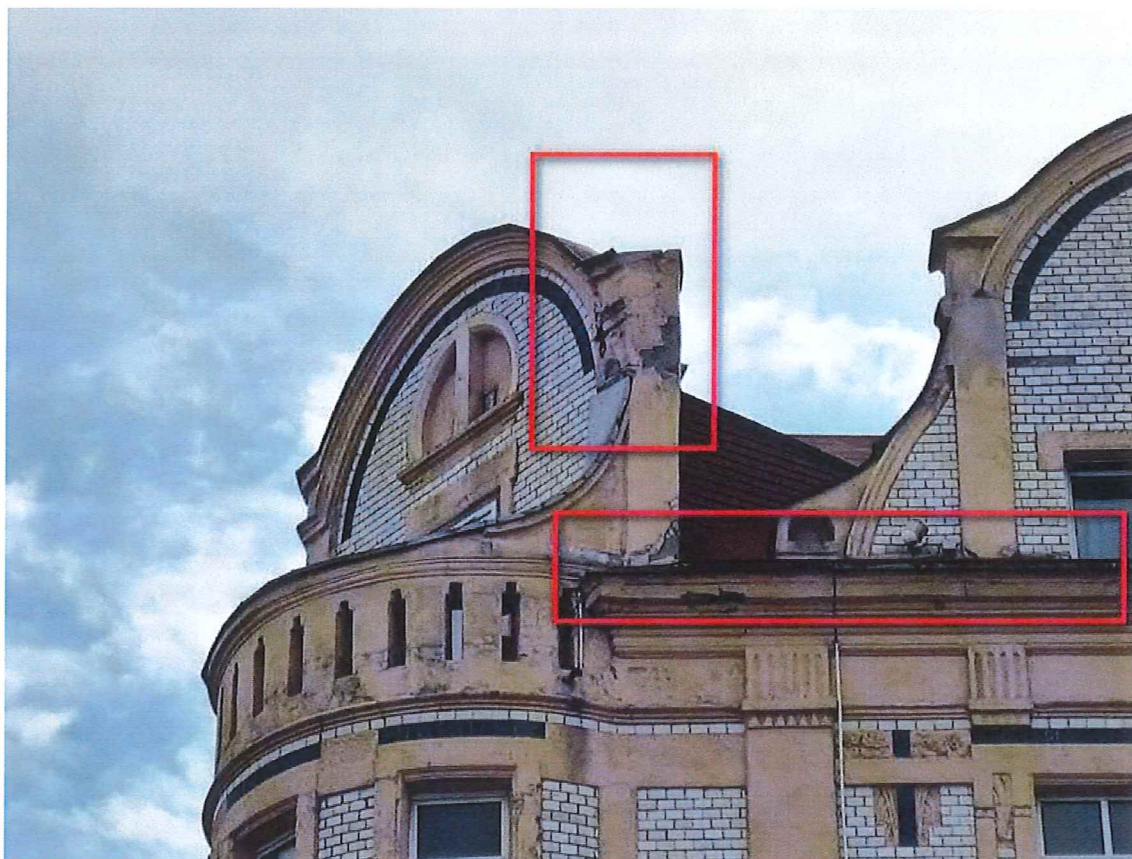
Fot. 6. Zbliżenie na fragment attyki i gzymsu do przemurowania (od strony ul. Bytomskiej).
